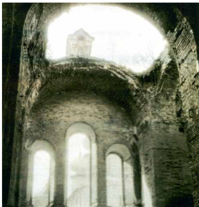
97. Крестовоздвиженская церковь. Покрытия и конструкции основного помещений 2-го этажа в аварийном состоянии. Вид на западную стену. Фото ЛО СНРПМ. 1964. Архив СПР
