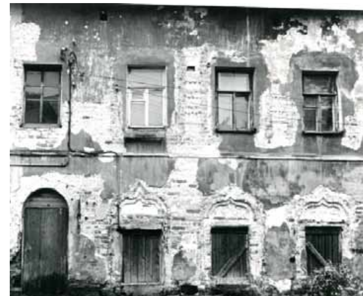
135. Южные братские кельи. Фрагмент северного фасада в процессе раскрытий. Фото Е. В. 1984
