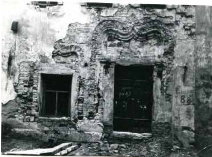
161. Архимандричьи кельи. Портал главного входа и наличник оконного проема в процессе раскрытия. Фото А.В. Плошко. 1979
